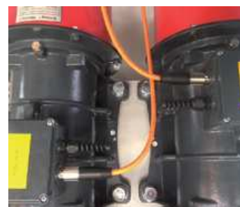
Cableado de vibradores sin posibilidad de confusión
